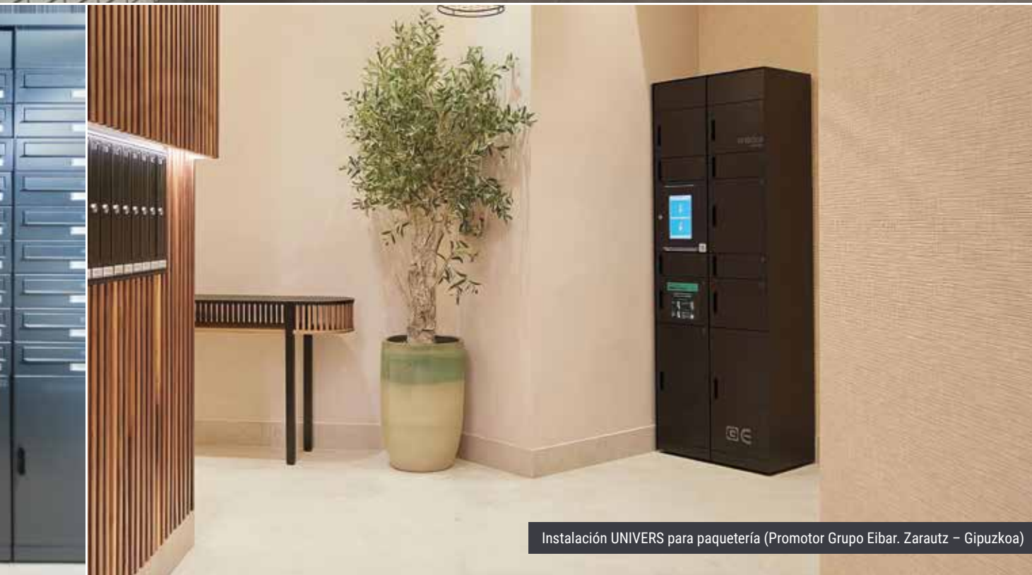
Instalación UNIVERS con buzones de paquetería y de correo (Promotora Kronos Homes. Valladolid)
